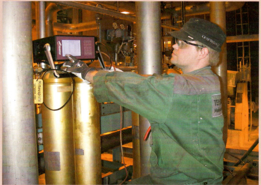
Kuva 4. Milko Lehmus valvoo kiertovoitelukeskukselta lähtevän öljyn puhtautta kannettavan on line -hiukkaslaskimen näytöltä UPM-Kymmene Oyj Kaipolan paperitehtaalla.
